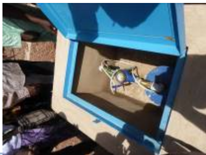
Tête de forage et compteur sécurisés
