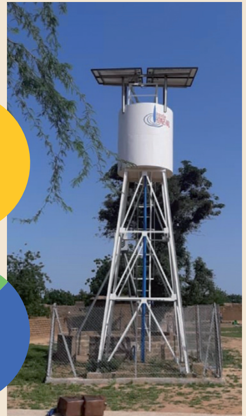
Château d'eau avec alimentation de la pompe par énergie solaire © Forages Mali
